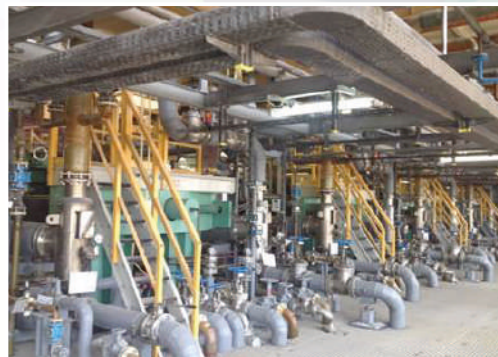
Технологические трубопроводы и оборудование корпуса 101, мембраны 9-го электролизера
